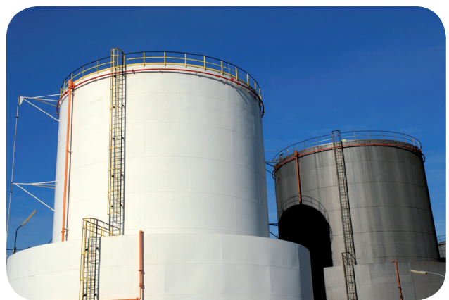
Depósitos fijos de líquidos inflamables. Se observa el cubeto que contendría los hidrocarburos en caso de derrame de algún depósito.
